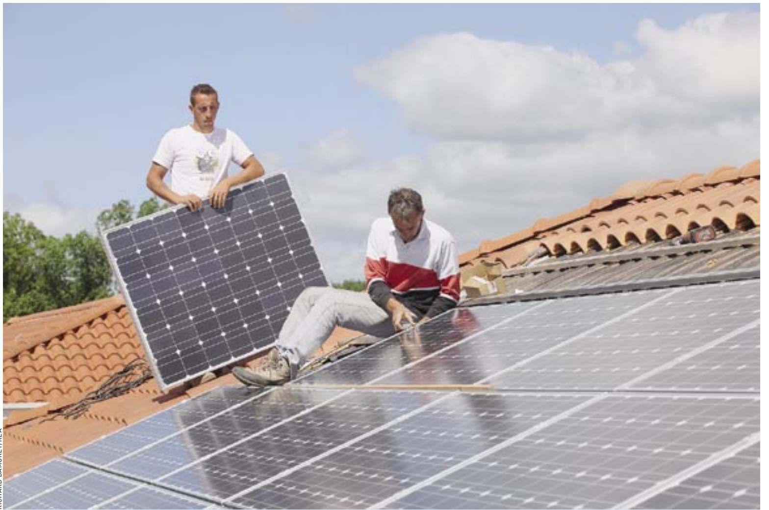
Pose de panneaux photovoltaïques sur le toit d'une école par une association de production citoyenne et locale d'énergies renouvelables (Puy-de-Dôme).
